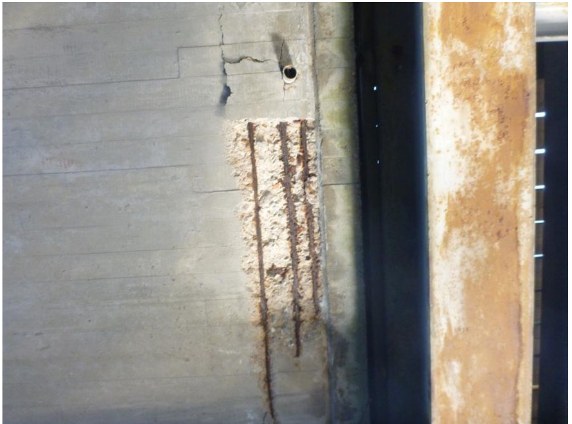
Kuva 25. Kansilaatan reunoissa on yleisesti erittäin vakavaa ruostumista.
