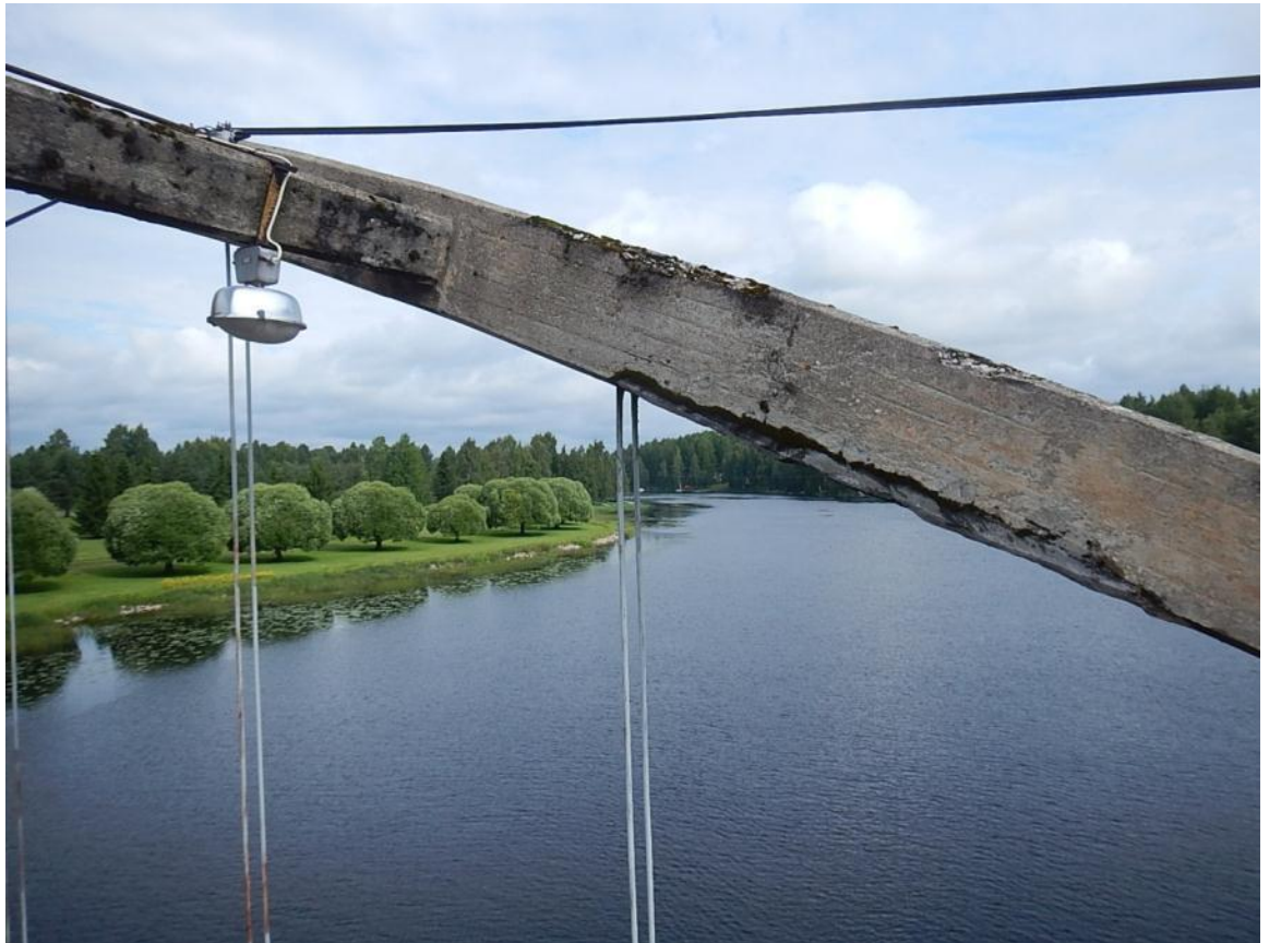
Kuva 19. Keskustan puoleisen kaaren vanhoja paikkauksia ja ruostumista.
