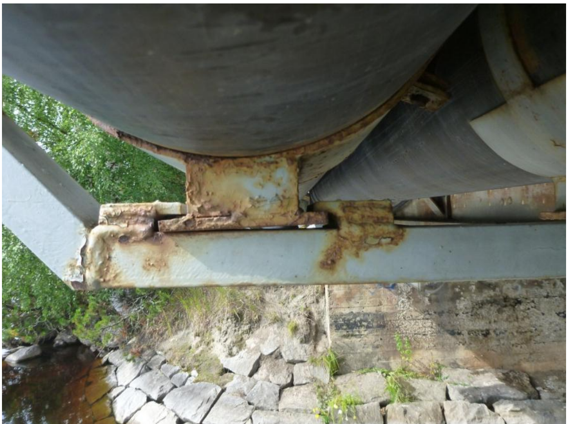
Kuva 47. Putken kiinnikkeissä on ruostumista etenkin hitsiliitoksissa.
