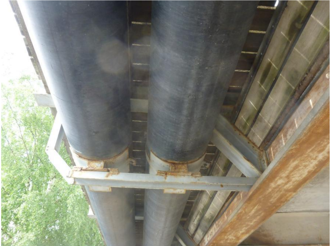
Kuva 46. Kaukolämpöputken kannattimet. Nurkassa on lautarakenteinen kaapelikouru.
