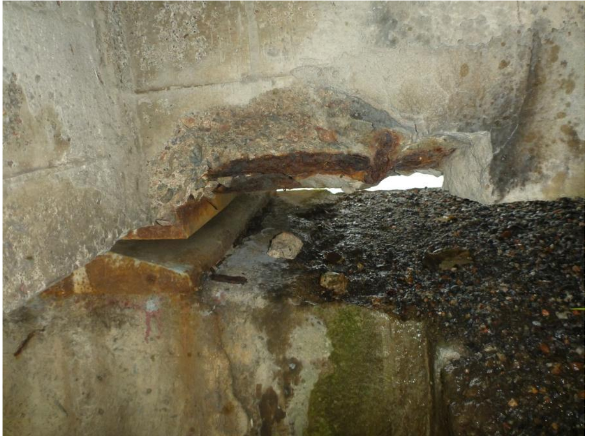
Kuva 26. Kansilaatan pään ruostumista välituella.
