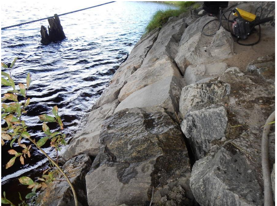
Kuva 48. Rantalan puoleinen etuluiska ja osa täysin lahonnutta tukiseinää.
