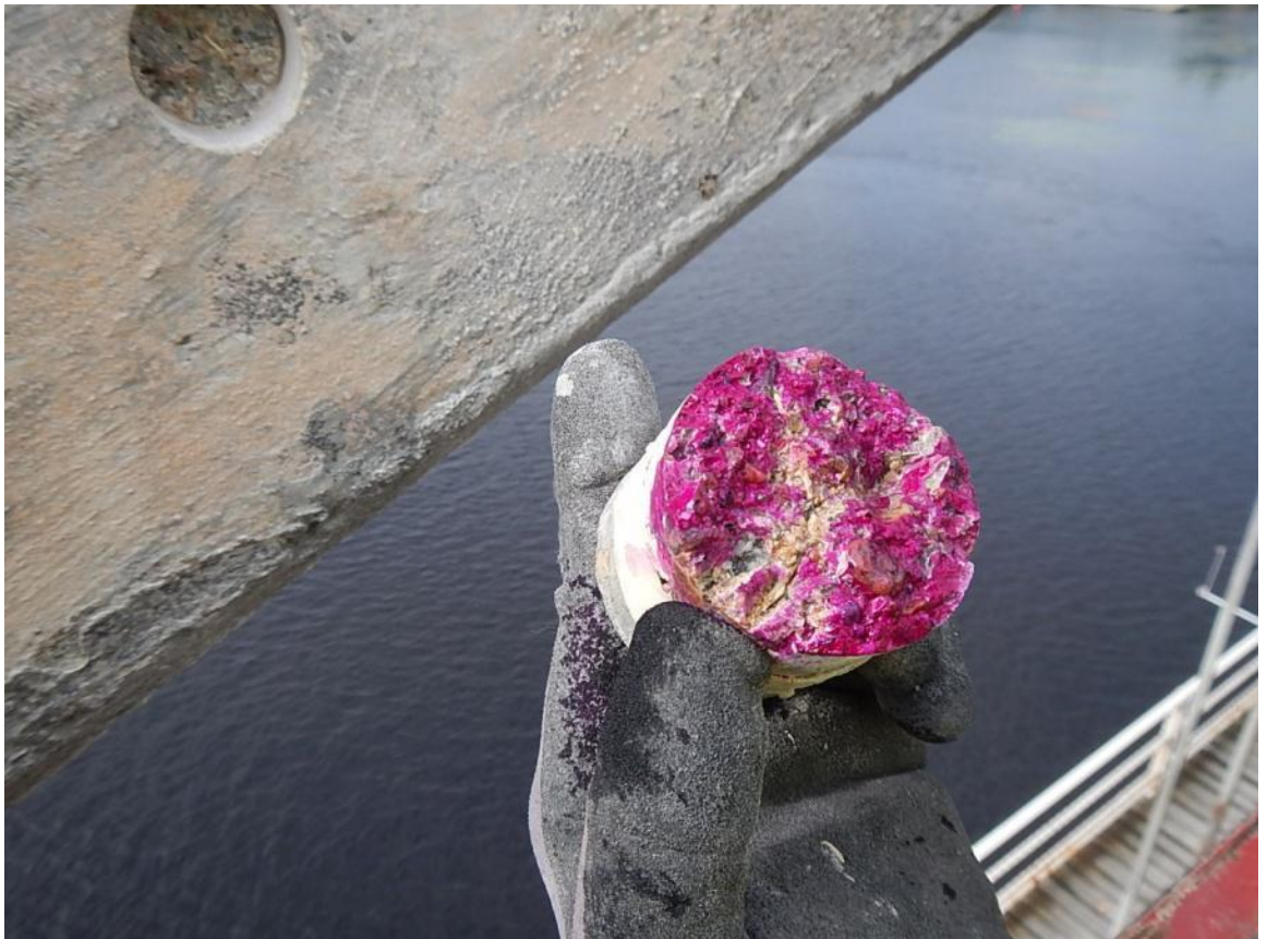
Kuva 21. Kaaresta tehdyn vetokokeen murtopinnassa näkyy betonin halkeilua.
