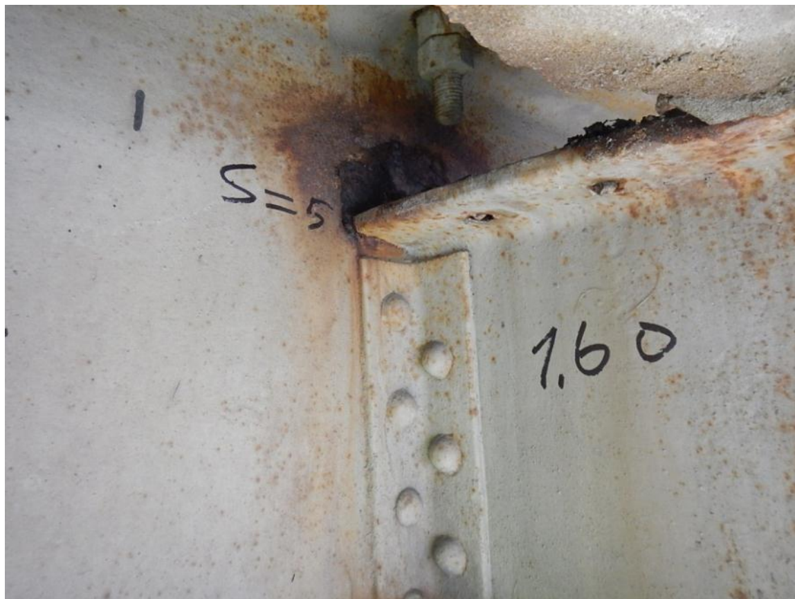
Kuva 33. Kuvassa poikkipalkin 1.6 oikeanpuoleinen liitos jossa on 5mm pistemäinen syöpmä.
