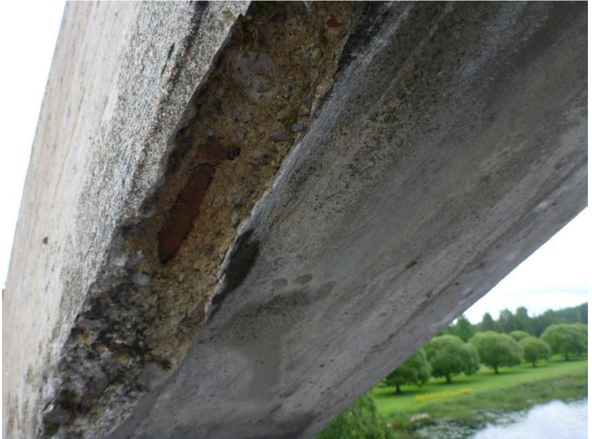
Kuva 20. Keskustan puoleisen kaaren ruostumista.
