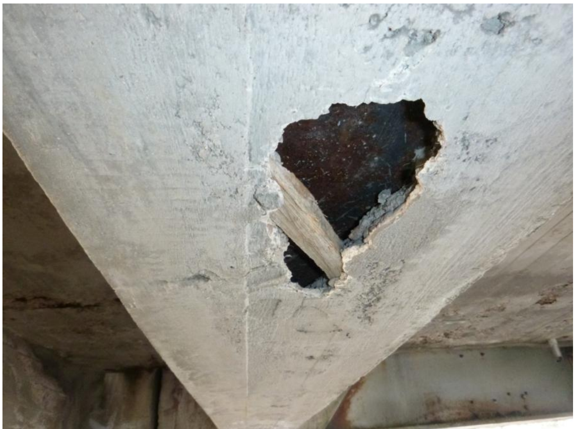
Kuva 27. Kansilaatan päätypalkin lohkeama on paljastanut kantavan teräspalkin.
