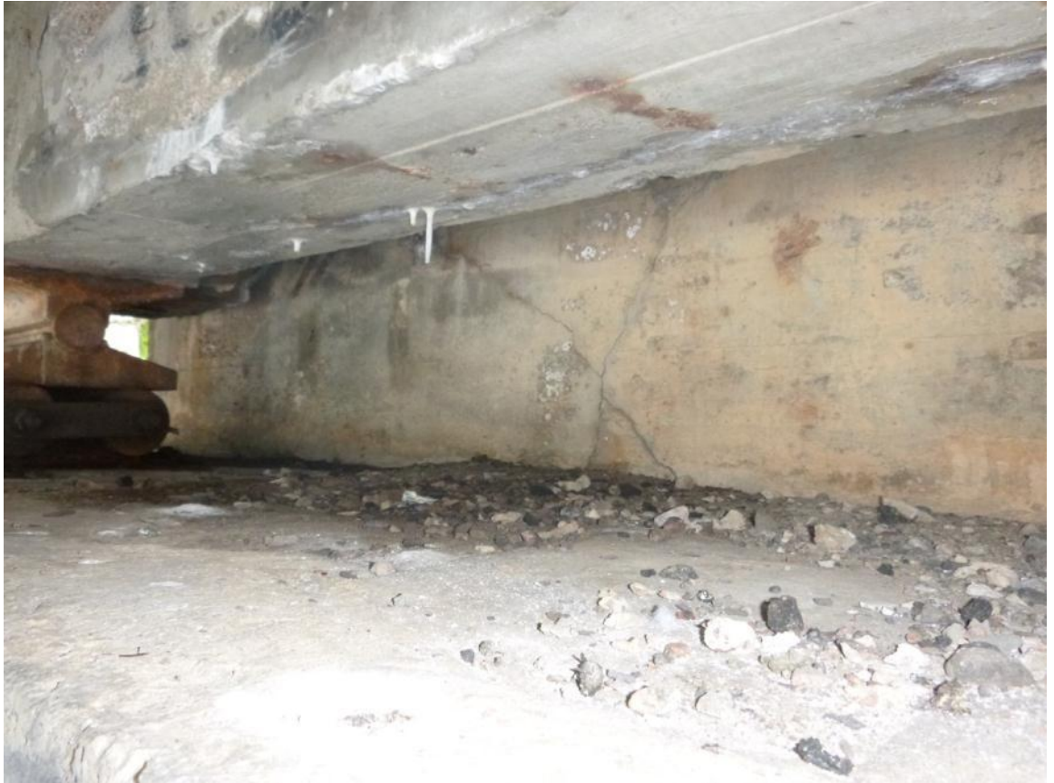
Kuva 12. Otsamuurin halkeilua Rantalan puoleisella maatuella.
