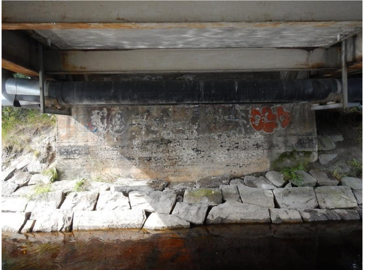
Kuva 11. Molempien etumuurien betonipinnat ovat vakavasti rapautuneet.
