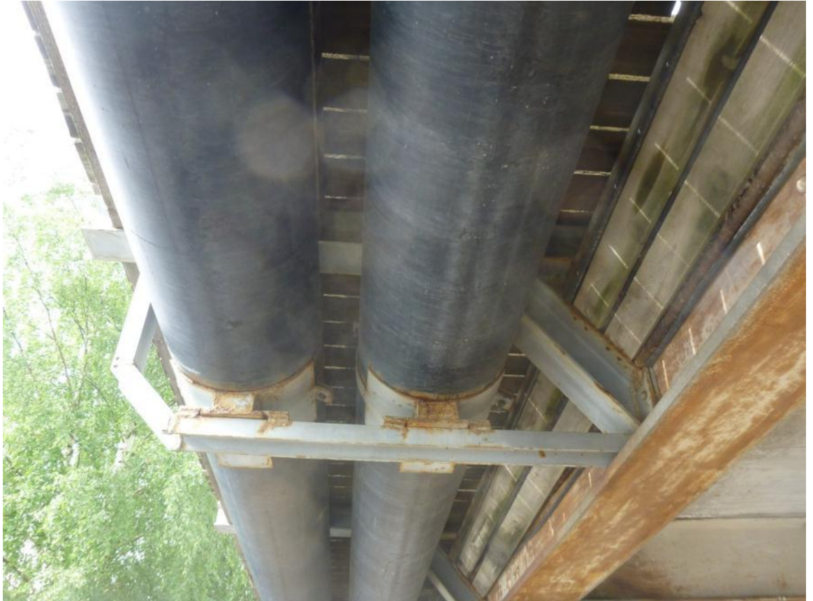
Kuva 46. Kaukolämpöputken kannattimet. Nurkassa on lautarakenteinen kaapelikouru.
