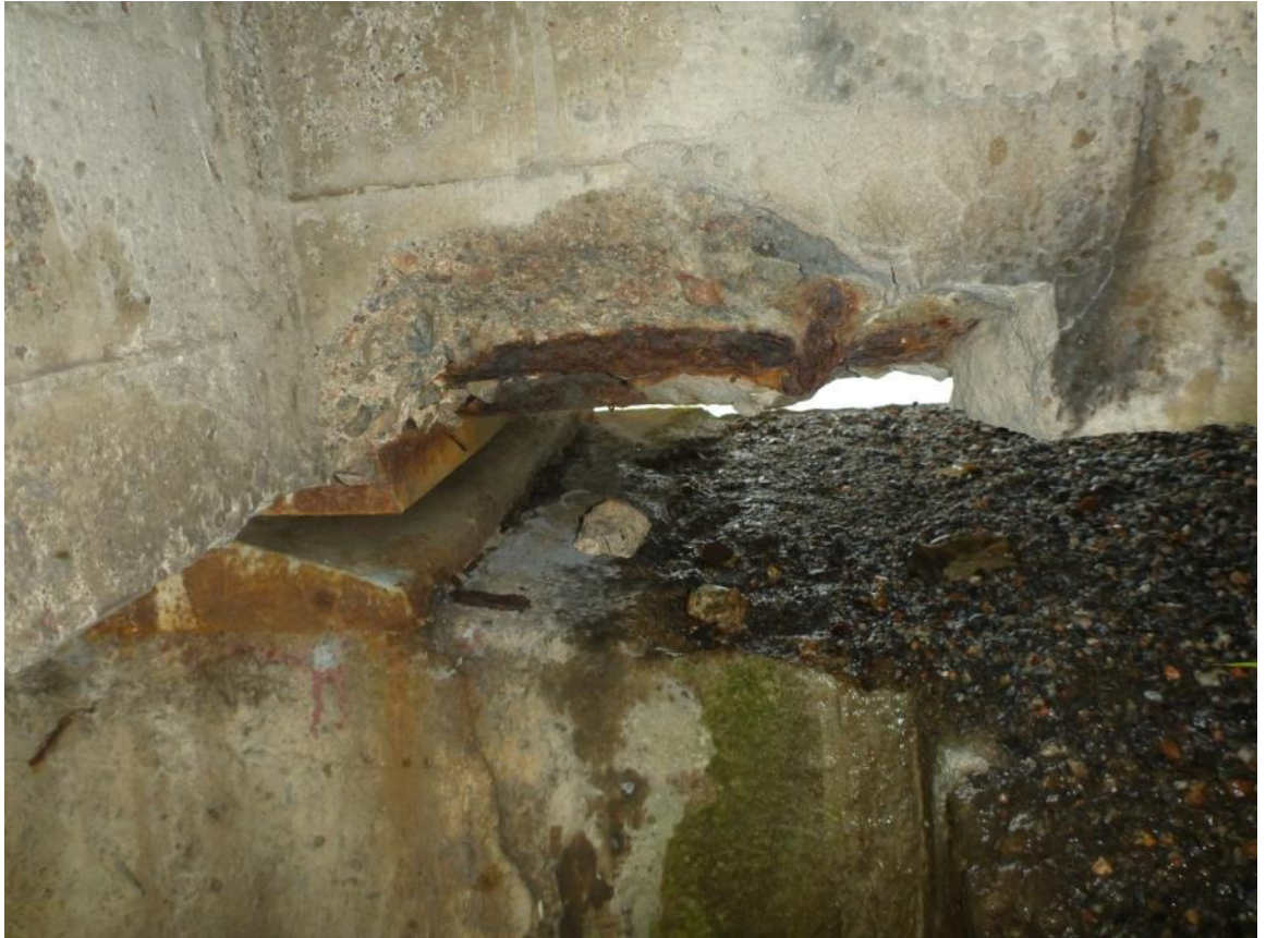
Kuva 26. Kansilaatan pään ruostumista välituella.
