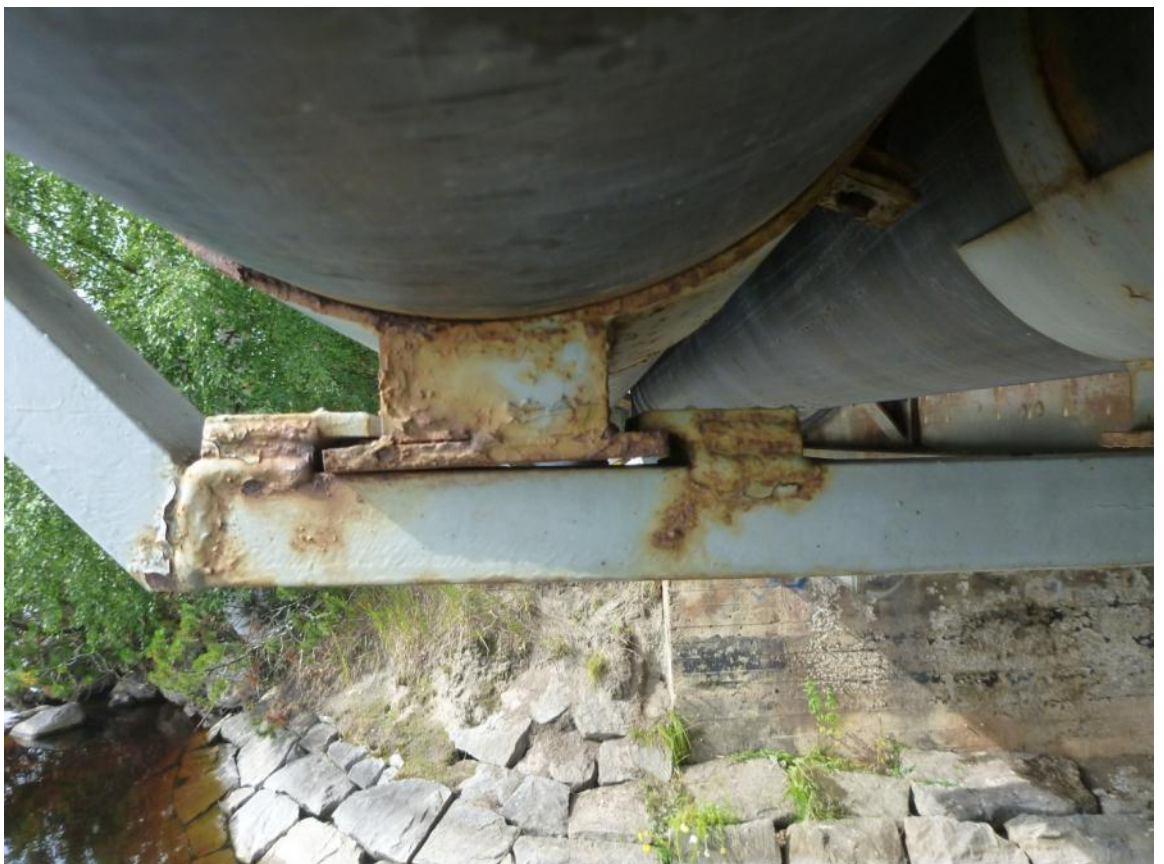
Kuva 47. Putken kiinnikkeissä on ruostumista etenkin hitsiliitoksissa.
