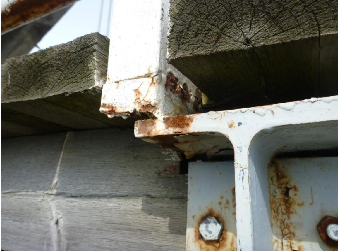
Kuva 39. Sillankaiteen ruostumista ja epämääräinen hitsiliitos.
