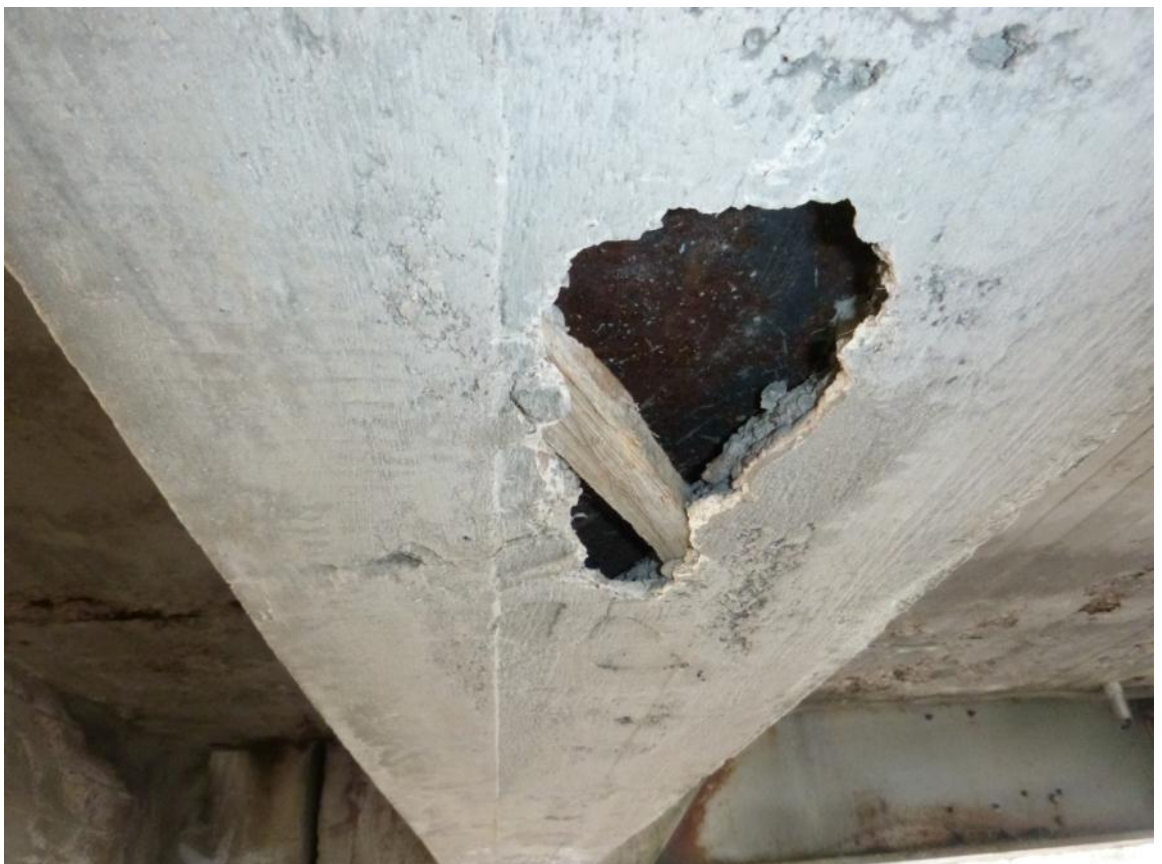
Kuva 27. Kansilaatan päätypalkin lohkeama on paljastanut kantavan teräspalkin.
