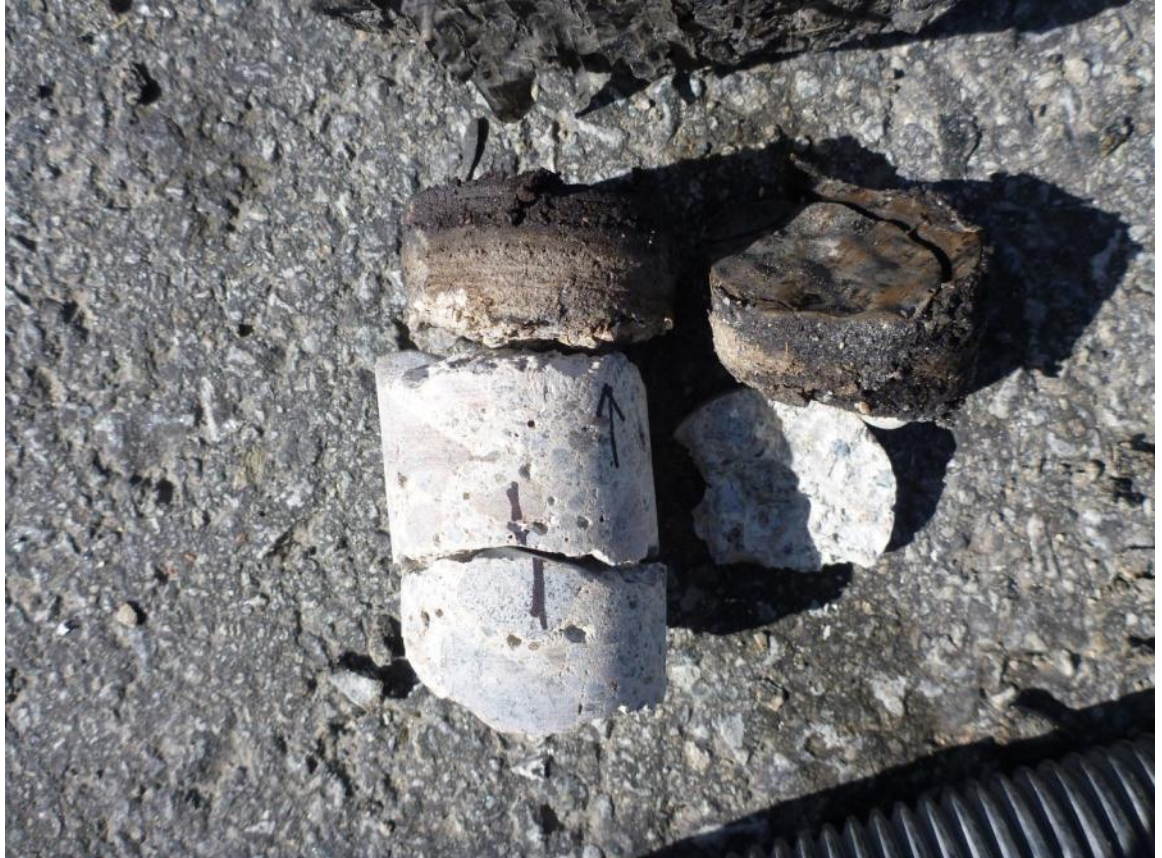
Kuva 37. Avauskohdan 3 (T1 + 58,3 m, vas. reunapalkki + 0,3 m). Kansilaatassa on vakavaa pakkasrapautumista ja kalkkihärmää.
