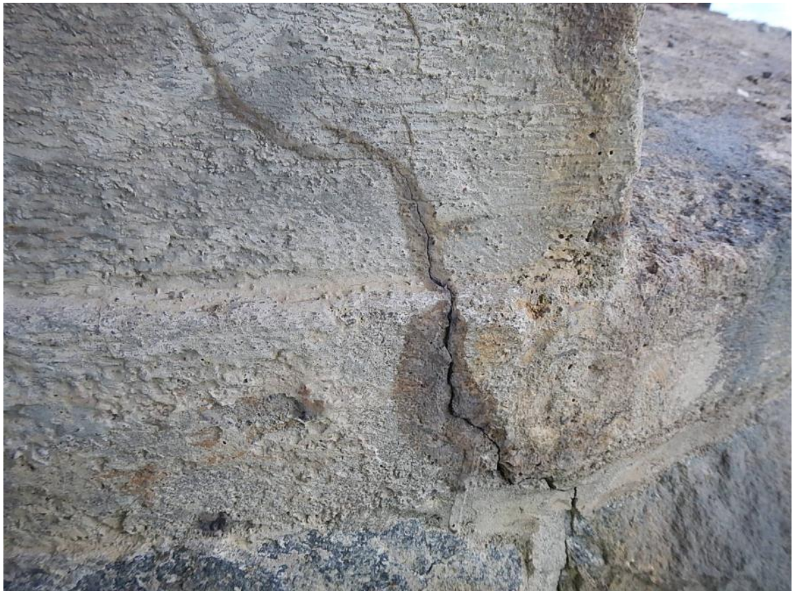
Kuva 15. Välituen yläosan halkeilua.
