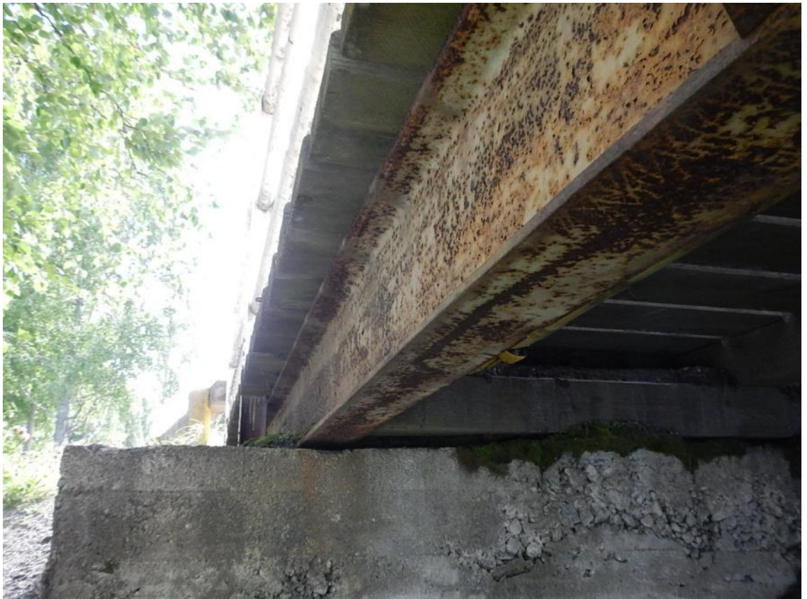
Kuva 13. Alusrakenteen reunaulokkeen pituuskannattajan ruostumista.
