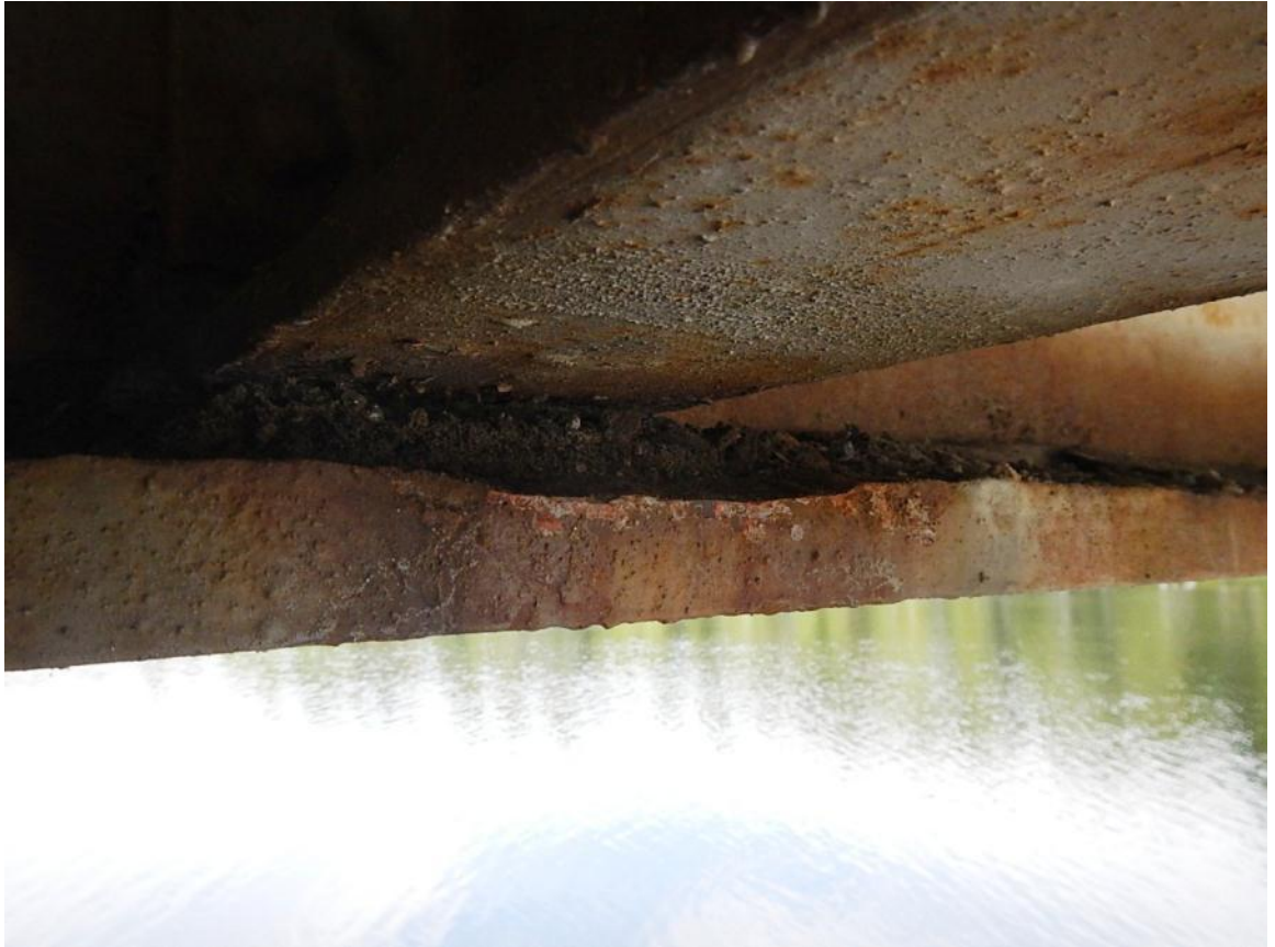
Kuva 34. Kuvassa poikkipalkin alle on kertynyt likaa ja alalaipan yläpinnassa vakavaa syöpymää 7...9 mm
